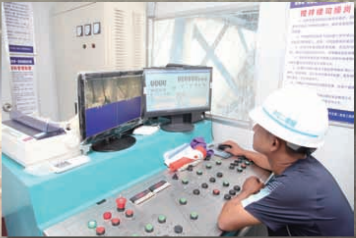
6# 拌合站操作室
